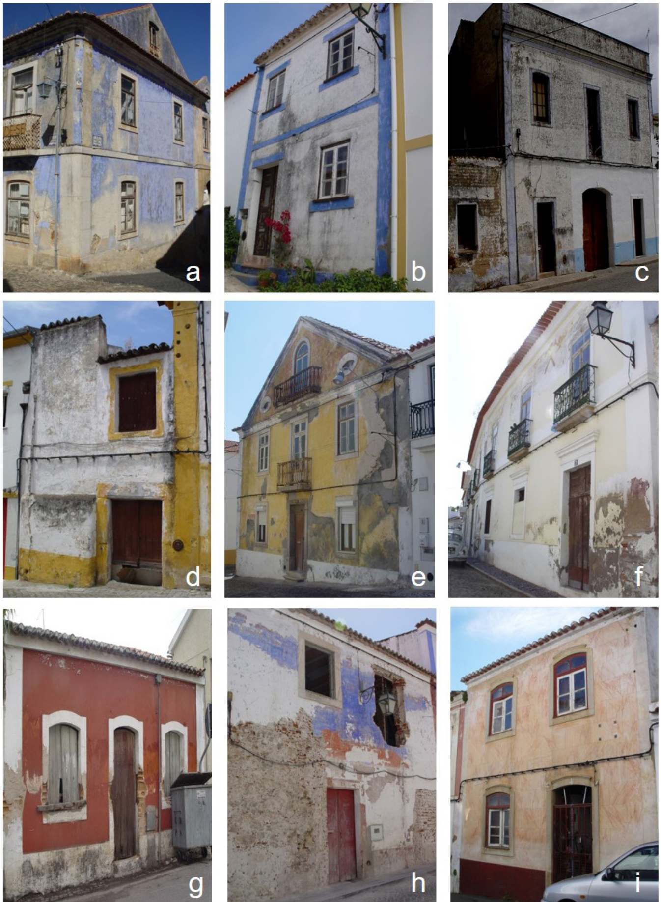
Figura 1. Exemplos de pinturas a cal no Património Edificado Português no Alentejo [17]: a) Santiago do Cacém; b) Odemira; c) Grândola; d) Crato; e) Sines; f) Moura; g) Ponte de Sôr; h) Arraiolos; i) Almodôvar.
