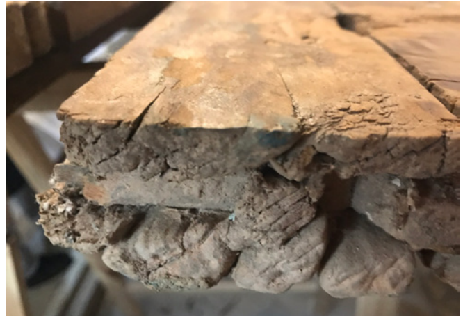
Figura 5. Podridão de partes do suporte existentes em sua parte inferior (2013) (foto: Tatiana Penna).
