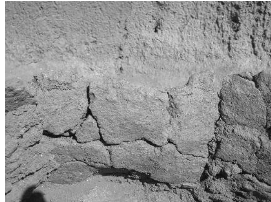
Fig. 6 Defesa de Cima 2: detail of pit 5 interior renderings (photo: Filipe Santos/ Arqueohoje).
