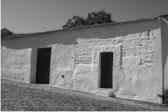
Fig. 6 Portugal, Vila Ruiva (Beja). Casa construída em paredes de taipa, protegidas por camadas de caiação e reboco em cal e areia.
