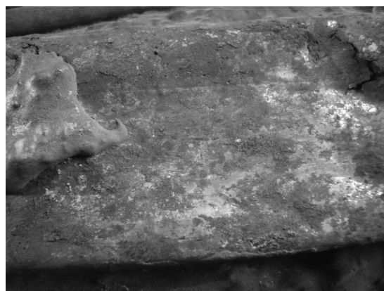
Fig. 16 Detalle de la corrosión en el tubo de hierro central.
