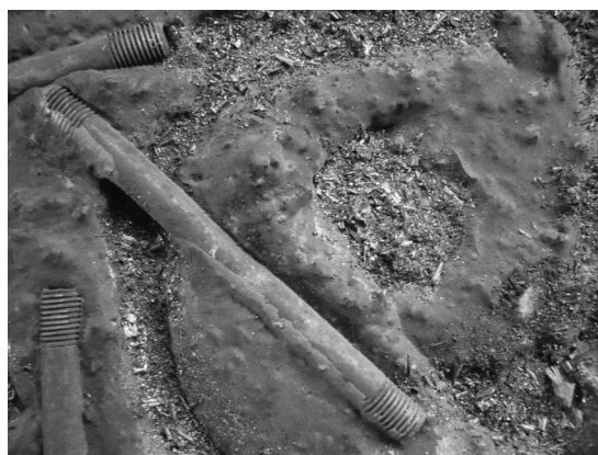
Fig. 9 Detalle del tubo de hierro oxidado.
