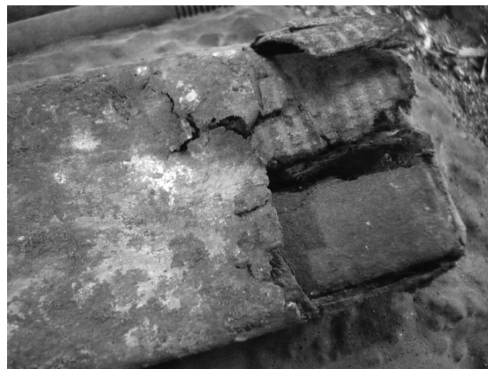
Fig. 15 Detalle con luz visible de las fisuras en el tubo de hierro central.
