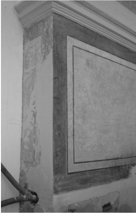
Fig. 7 Chafariz do Largo de São Mamede: após preenchimento das lacunas com argamassa, procedeu-se à sua reintegração cromática a aguarela.
