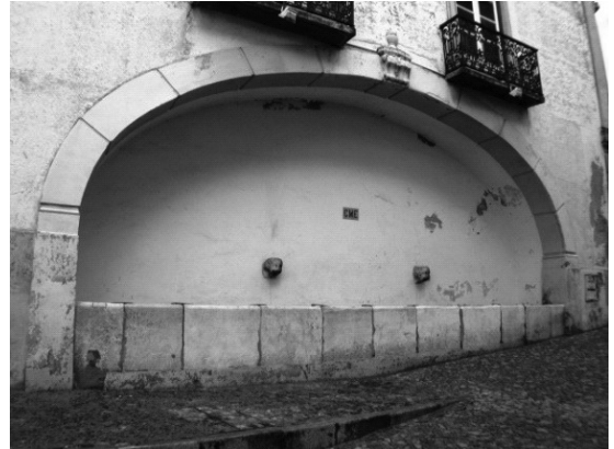
Fig. 13 Chafariz de Alconchel: vista geral antes da intervenção.
