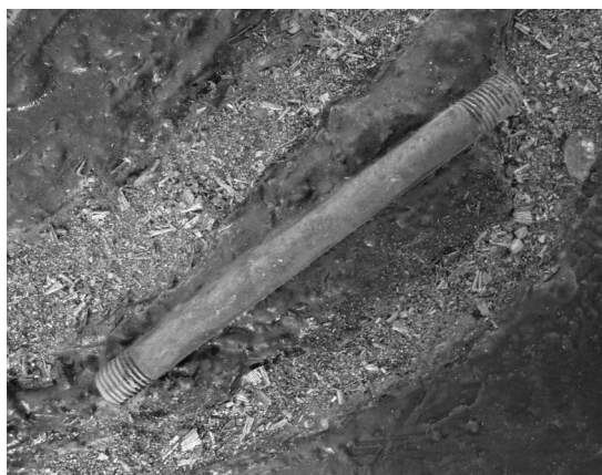
Fig. 24 Tubo de hierro antes de la aplicación del consolidante.
