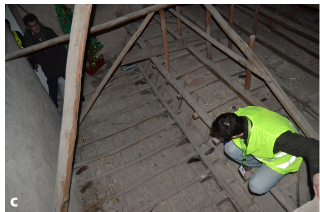
Figura 5. Processos de inspeção: a) inspeção da envolvente exterior; b) inspeção de um pavimento; c) inspeção de uma cobertura.
