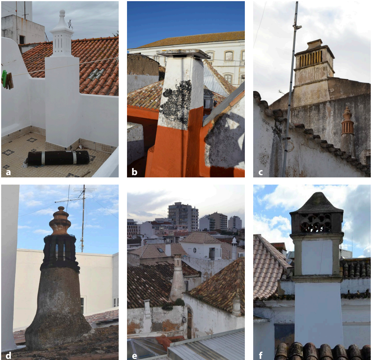
Figura 13. Exemplos de várias configurações de chaminés existentes no Bairro Ribeirinho.
