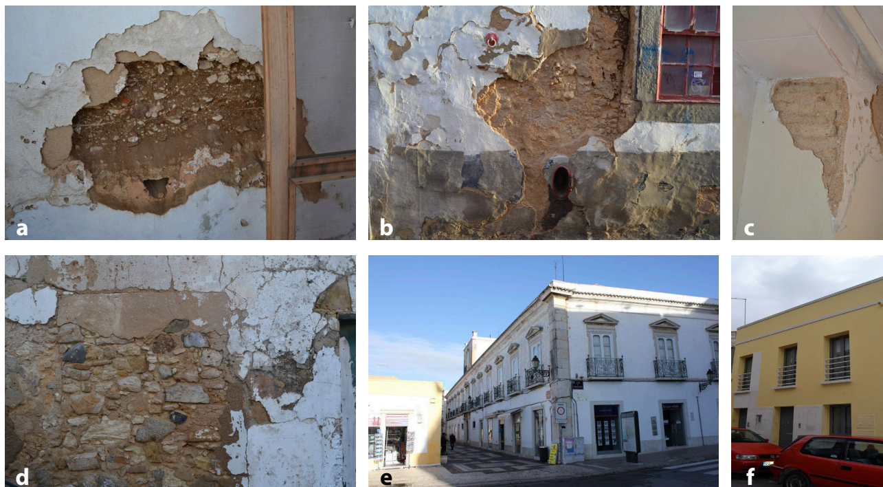
Figura 2. Exemplos das diferentes soluções construtivas encontradas no edificado do Bairro Ribeirinho: a) e b) construção mista em taipa com fragmentos de pedra argamassados com areia, terra e cal; c) construção mista em taipa com alvenaria de blocos de adobe; d) construção em alvenaria de pedra muito pobre com a presença de vários detritos; e) construção mista de melhor qualidade, em taipa, com cantarias e cunhais em pedra calcária; f) estrutura porticada em betão armado.
