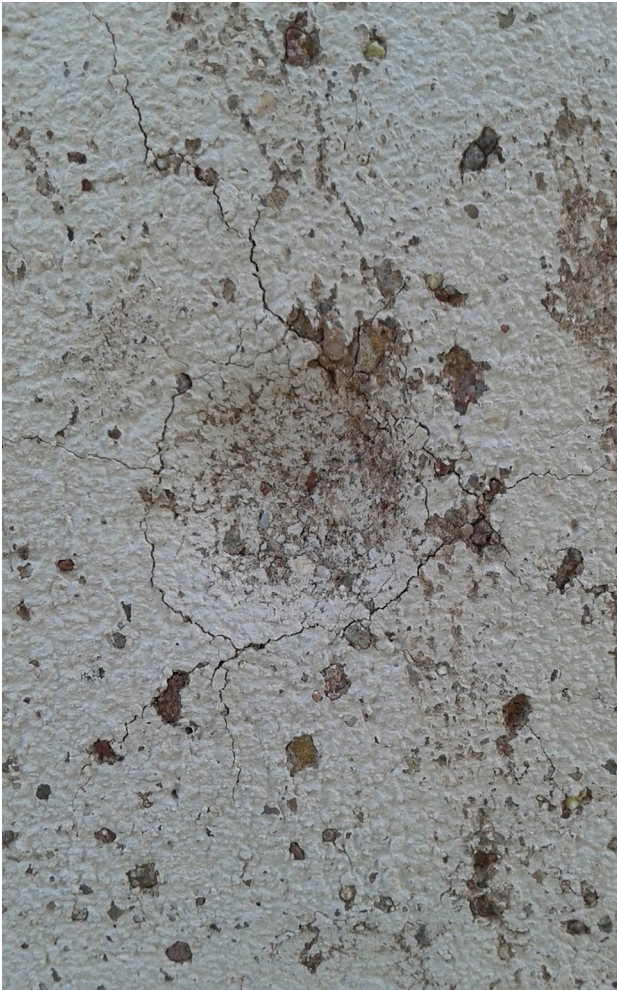
Figura 8. Aspeto da superfície do reboco E_WS+NHL no ensaio de Martinet-Baronnie, sendo visível a moessa acompanhada por fissuras.
