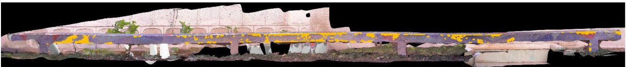
Figura 13. Mapeamento das zonas com desprendimento de pastilhas na face frontal.
