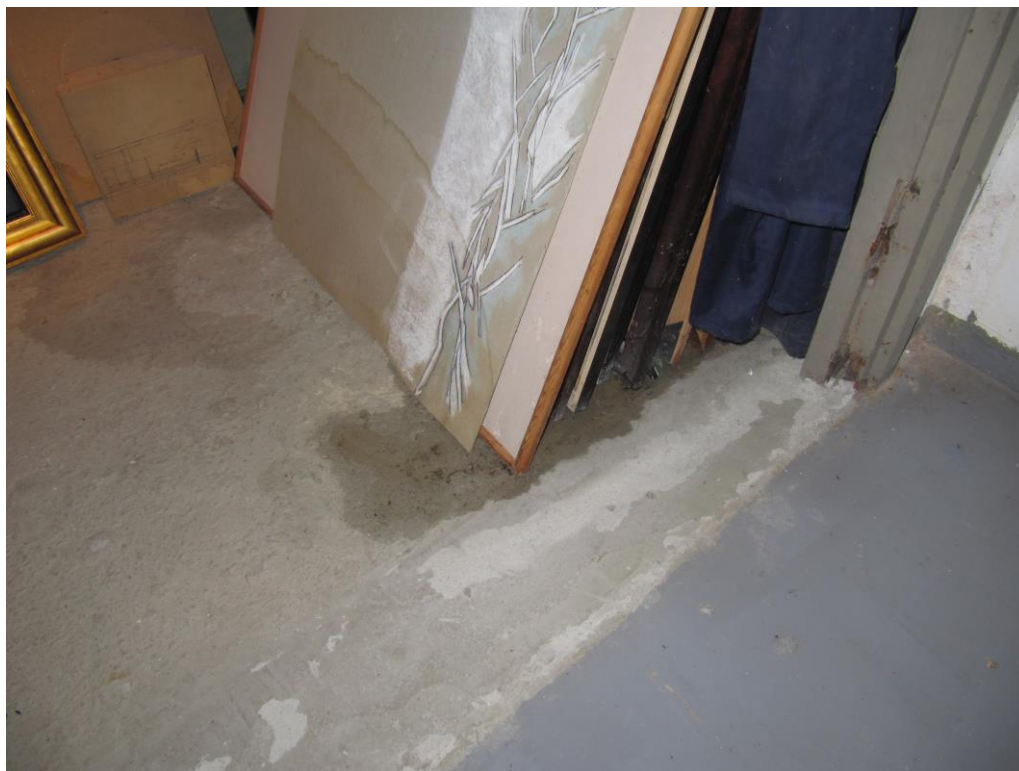
Figura 3. Vistas de zonas con filtraciones de agua afectando directamente a la obra.
