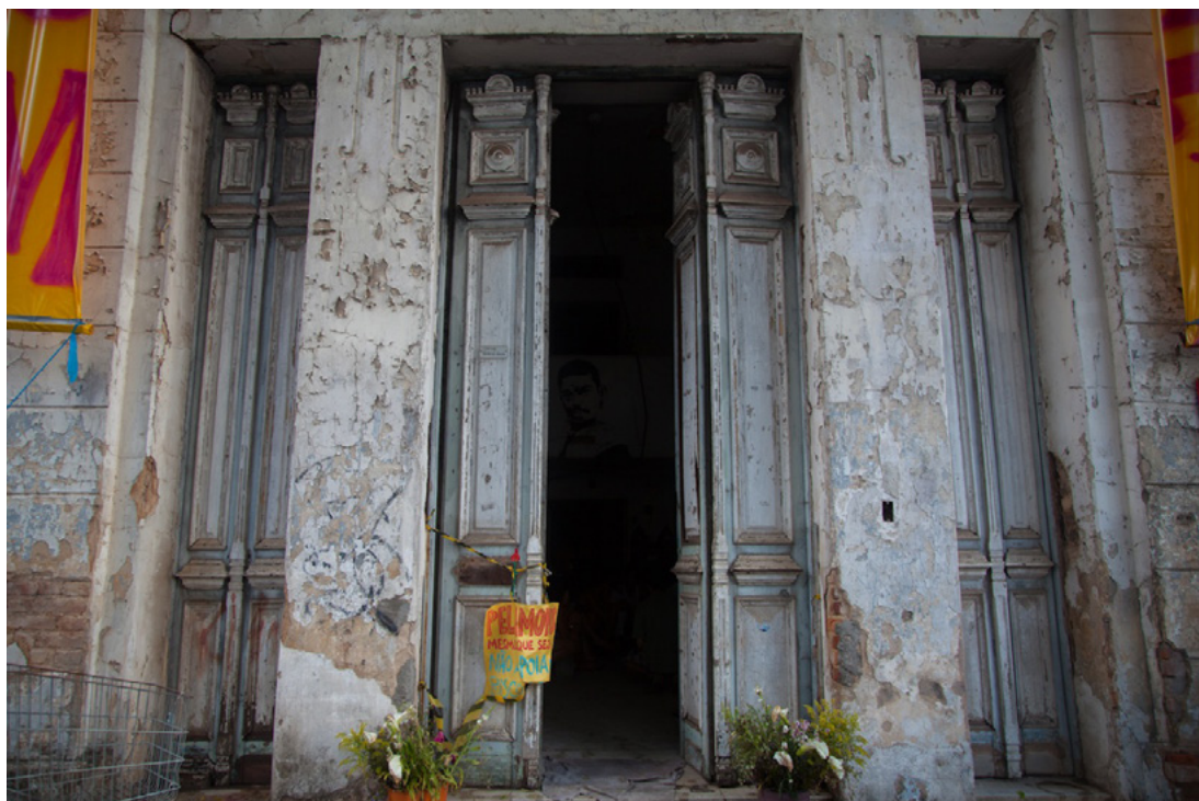
Figura 3. Tipos de portas presentes na fachada frontal do Casarão (2013) (foto: Priscila Musa).
