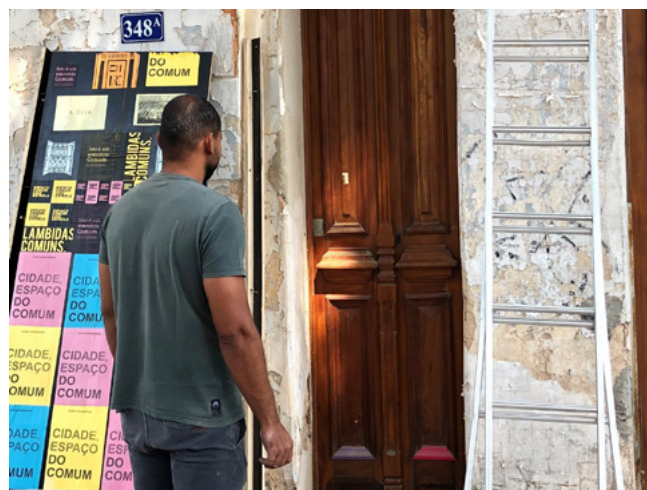
Figura 13. Parte inferior das portas laterais esquerdas com próteses instaladas (2019) (foto: Tatiana Penna).
