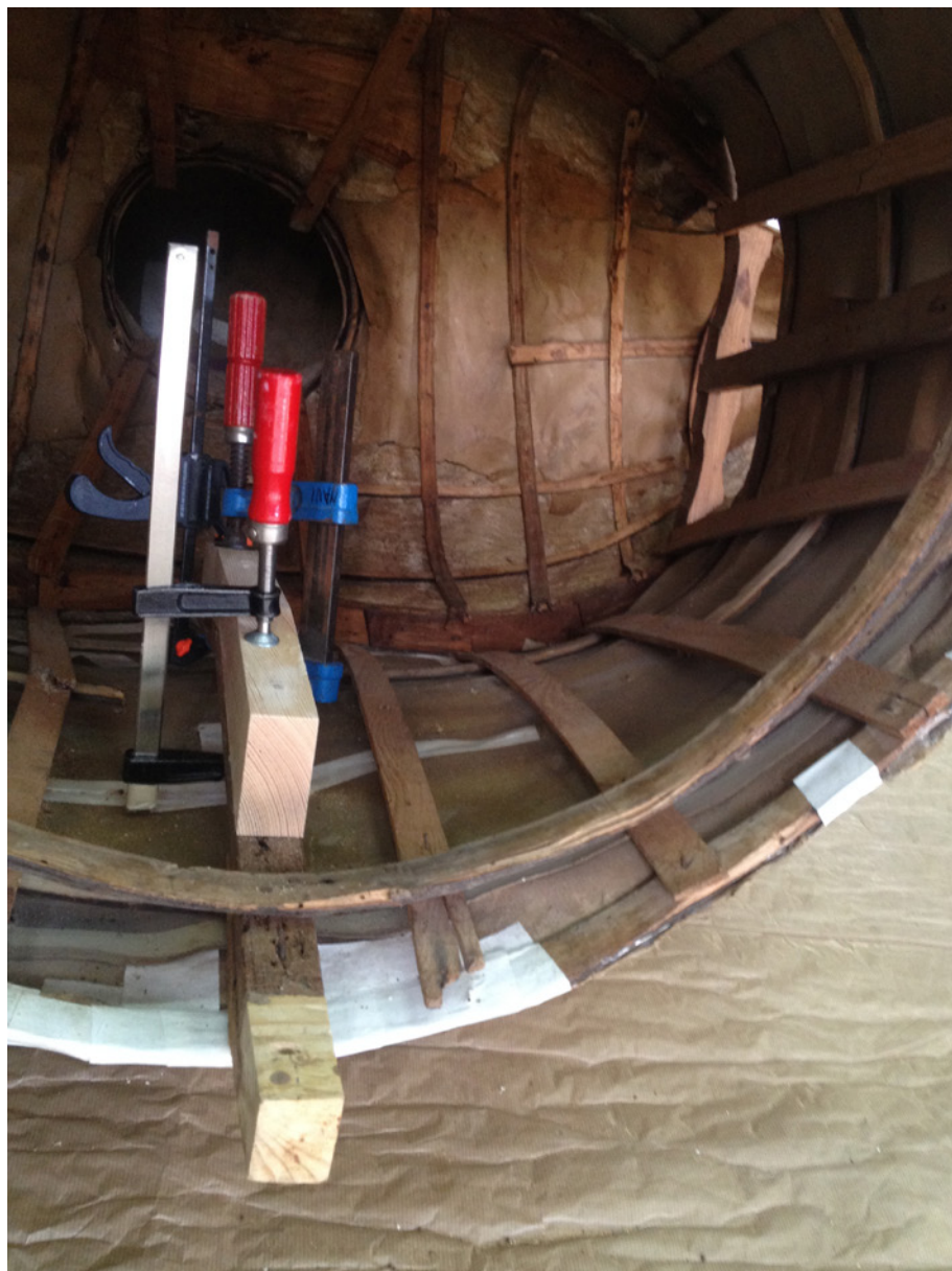
Figura 9. Intervención de estabilización en la estructura interna de madera, con la reposición de elementos lúgneos y solapamiento de estructuras de refuerzo.
