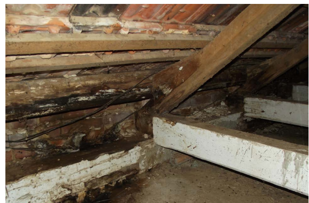
Figura 10. Madeiras escurecidas pela ação fúngica no sótão (lado B) da Casa da Cultura.
