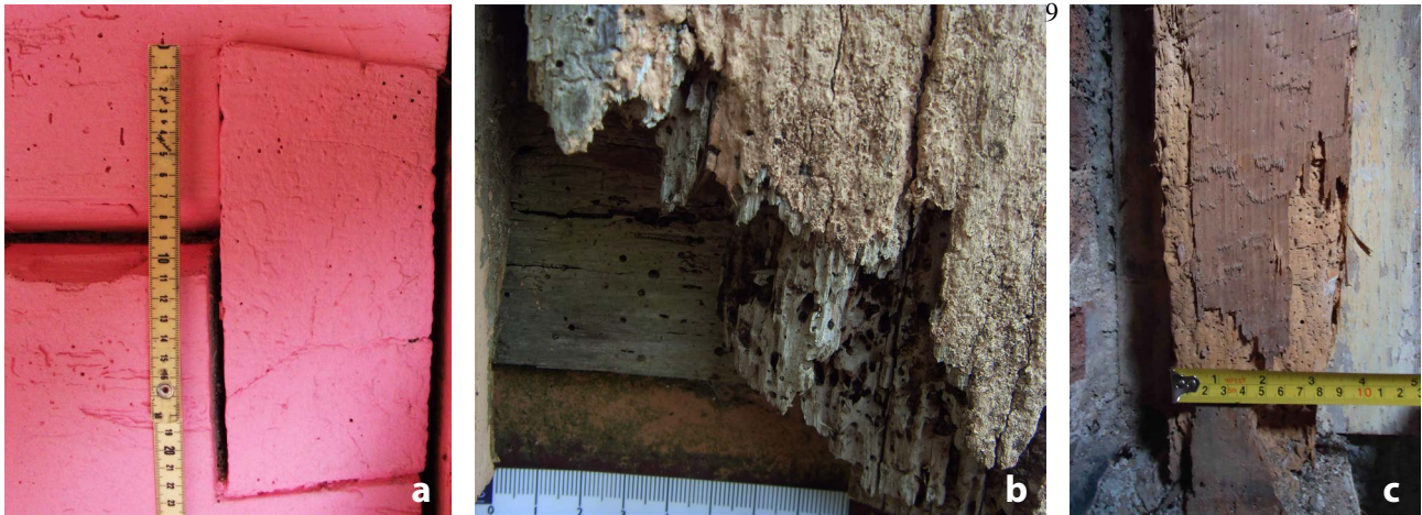
Figura 11. Sinais do ataque e os danos causados por insetos: a) orifícios de emergência e galerias, na parede da casa Grochocki; b) orifícios de emergência, galerias e perda de material, na parede da casa Cetnarski; c) orifícios de emergência, galerias e perda de material na base do pendural, do telhado da Casa da Cultura.
