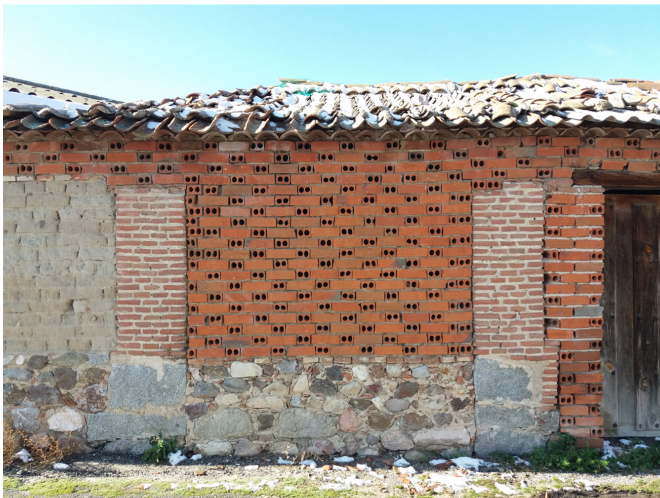
Figura 7. Santo Domingo de las Posadas (Ávila, España). Fábrica histórica con distintos aparejos (mampostería, adobe, ladrillo de tejar) y su reciente reparación con otro igualmente distinto (ladrillo hueco industrial). La innovación se enmarca en la tradición del proceso, y su aplicación constructiva no difiere esencialmente de la anterior.
