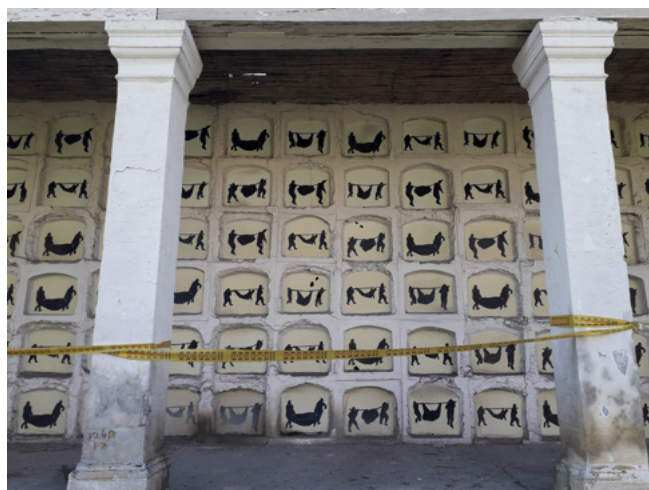
Figura 4. Vista de los Columbarios con cinta amarilla que restringe el paso de los visitantes. 2018. Fuente propia.
