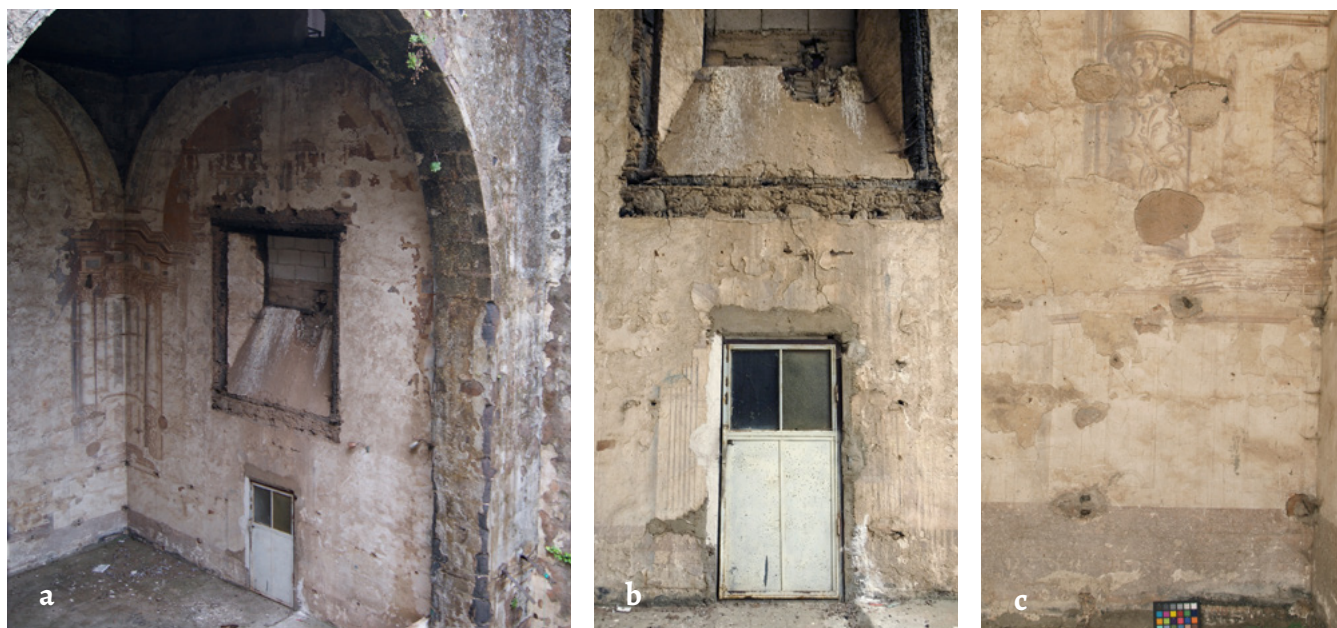
Figura 5. a) Vista general de los frescos en la actualidad. b) Detalle del paramento derecho, donde apreciamos abundantes pérdidas y gruesos depósitos que ocultan la policromía original. c) Esquina derecha de la pared central, afectada por la misma problemática.
